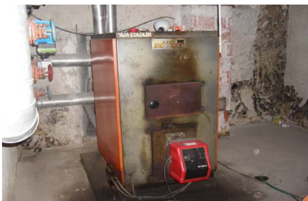
Slika 7: Potrebna obnova peči za centralno ogrevanje.
