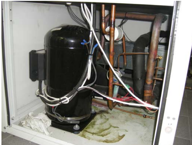
Slika 9: Notranji pogled kablov za klima napravo.
