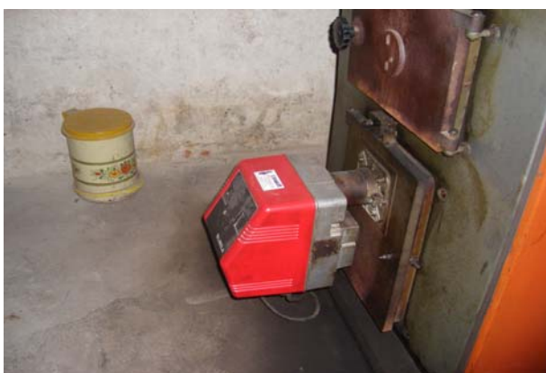
Slika 8: Prikaz slabega stanja kotlovnice, peči in gorilca za centralno ogrevanje.
