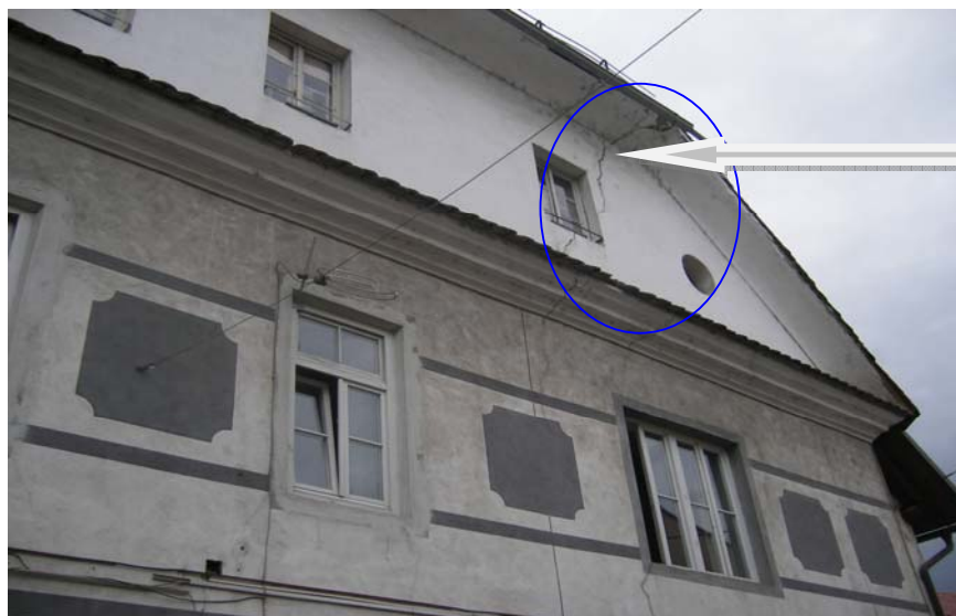
Slika 12: Razpoke na severni fasadi objekta.
