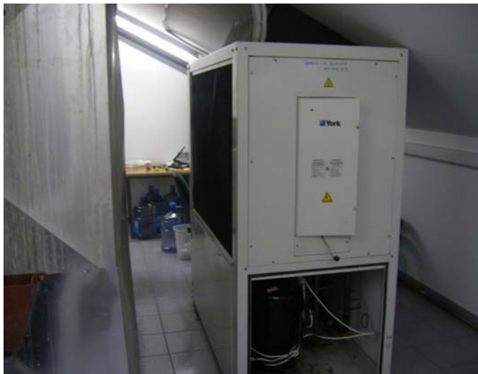
Slika 10: Klima naprava za mansardne pristore na Okrožnem sodišču v Celju.
