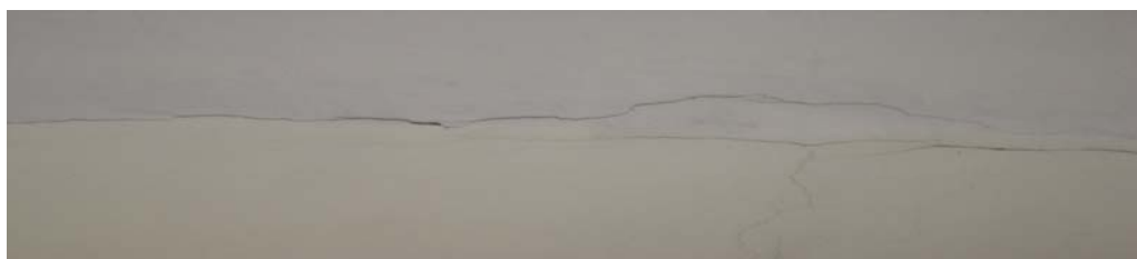
Slika 13: Razpoke v notranjosti sodnije zaradi dotrajanosti objekta
