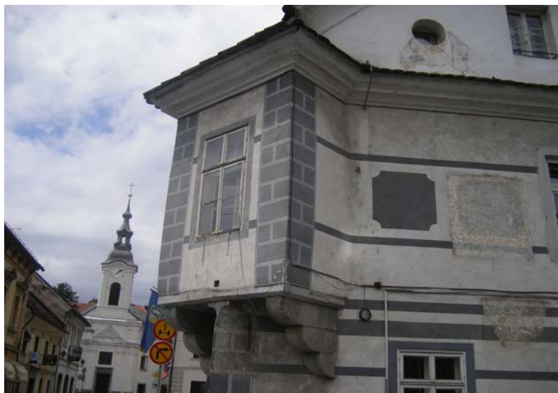
Slika 14: Prikaz slabega stanja fasade sodnije.
