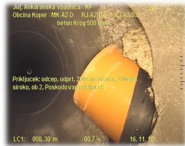
Slika 31: primer iz objekta Ankaranska vpadnica, ki smo jo izvajali leta 2010- gre za poškodovan priključek, zaradi katerega je kanalizacija na tem odseku puščala (vir: slikovni material Hidrospeleo d.o.o.)
