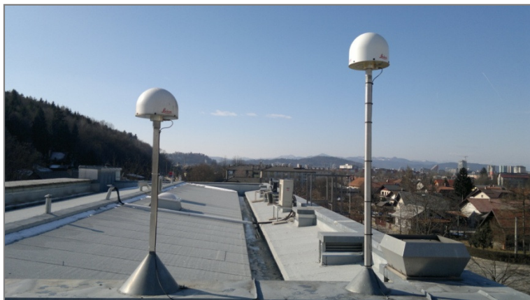
Slika 23: Na strehi poslovne stavbe na Litijski cesti 45 v Ljubljani sta nameščeni anteni stalno delujočih referenčnih postaj GSR1 (levo) in zasebne referenčne postaje podjetja Geoservis, d.o.o. (desno).
