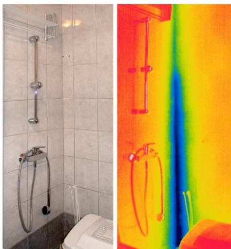
Slika 13: Površna vgradnja fasadne izolacije je razlog za toplotni most v hladnem kotu in posledično za nastanek kondenzacije ter plesni [13].
