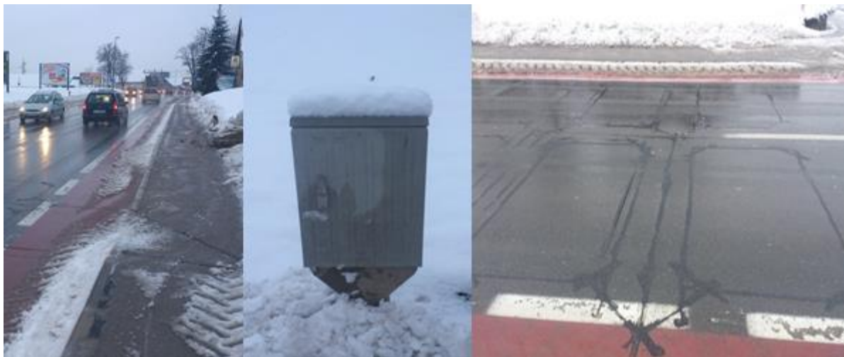
Slika 10: Indukcijske zanke v obrabni plasti vozišča in zaščitna omara v kateri je nameščena krmilna enota (Lasten vir, 2013)
