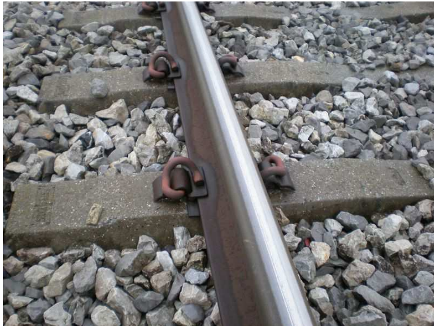
Slika 12: Elastična pritrditev Pandrol na betonskih pragih (lasten vir)
