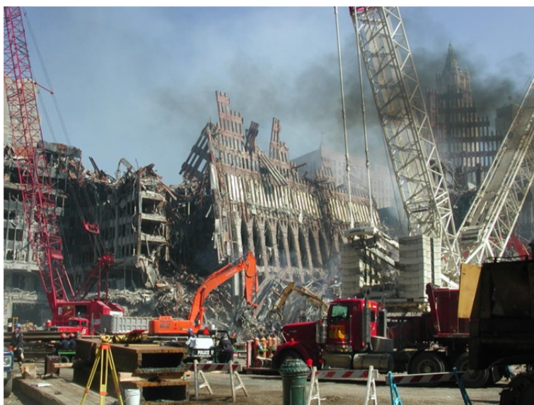
Slika 1.7: Porušitev Svetovnega trgovinskega centra v New Yorku
