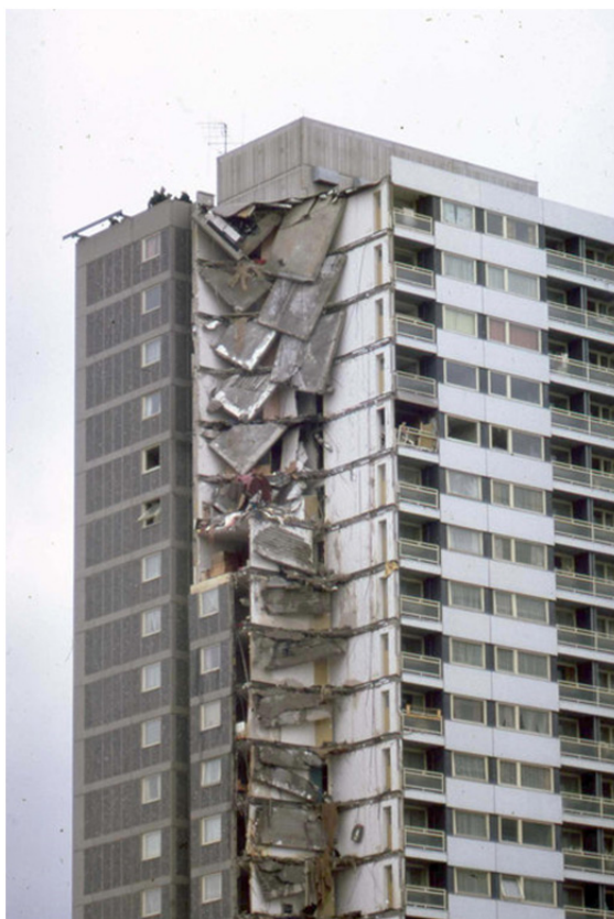
Slika 1.1: Porušitev stavbe Ronan Point
