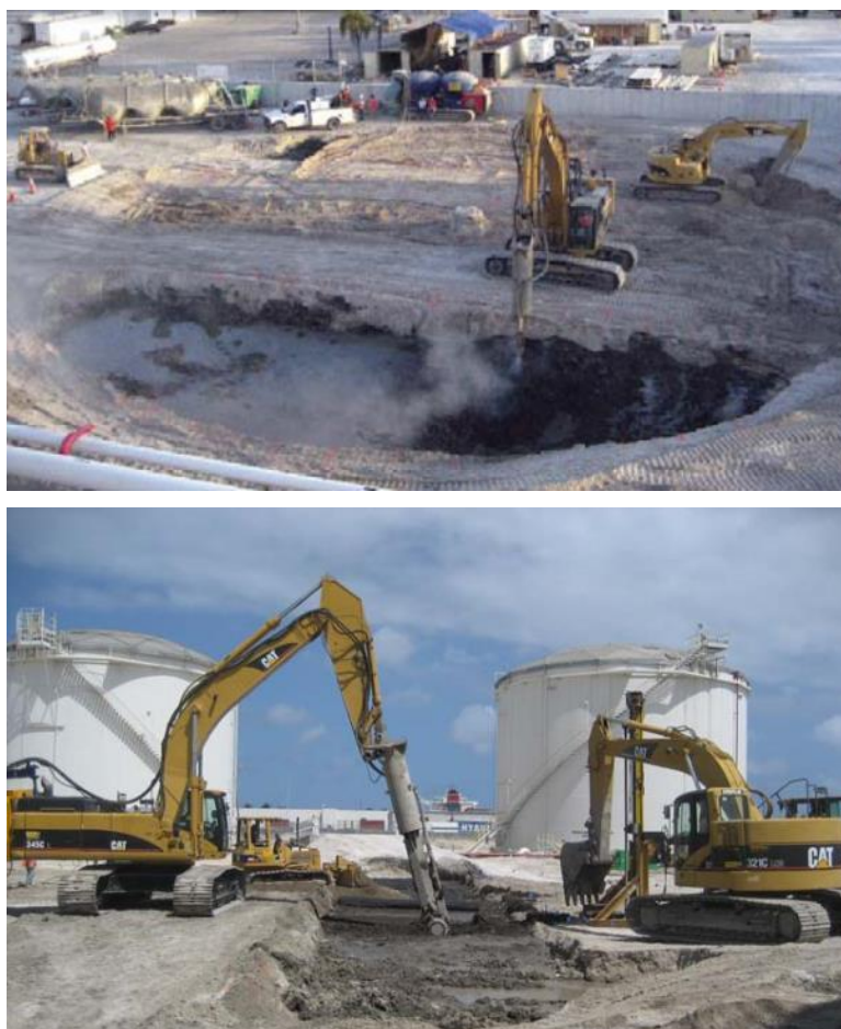
Slika 29: Izvedba mešanja stabiliziranega bloka zemljine pred gradnjo rezervoarjev v Port Everglades (Hayward Baker, 2009: str. 1).
