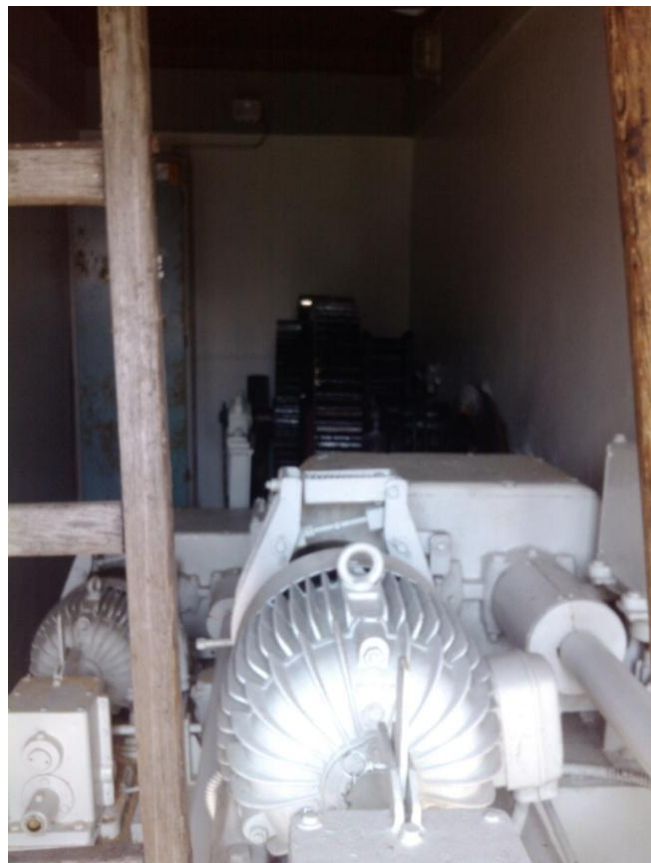
Slika 23: Strojnica obstoječih zapornic v stebni kabini desnega obrežnega stebra
