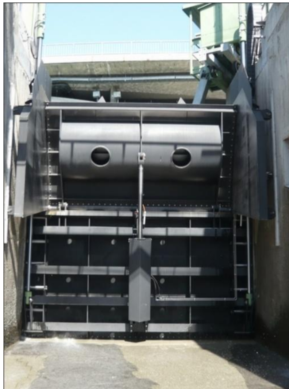
Slika 25: Vgrajena dvodelna tablasta zapornica z zaklopko, pripravljena na obratovanje (RADHUBER CONSULTING, 2007)
