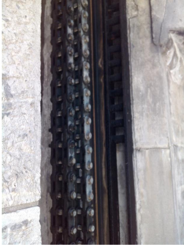
Slika 22: Pogon obstoječih zapornic: Gallove verige spodnje table (spredaj) in pogonski drog zgornje table (zadaj)
