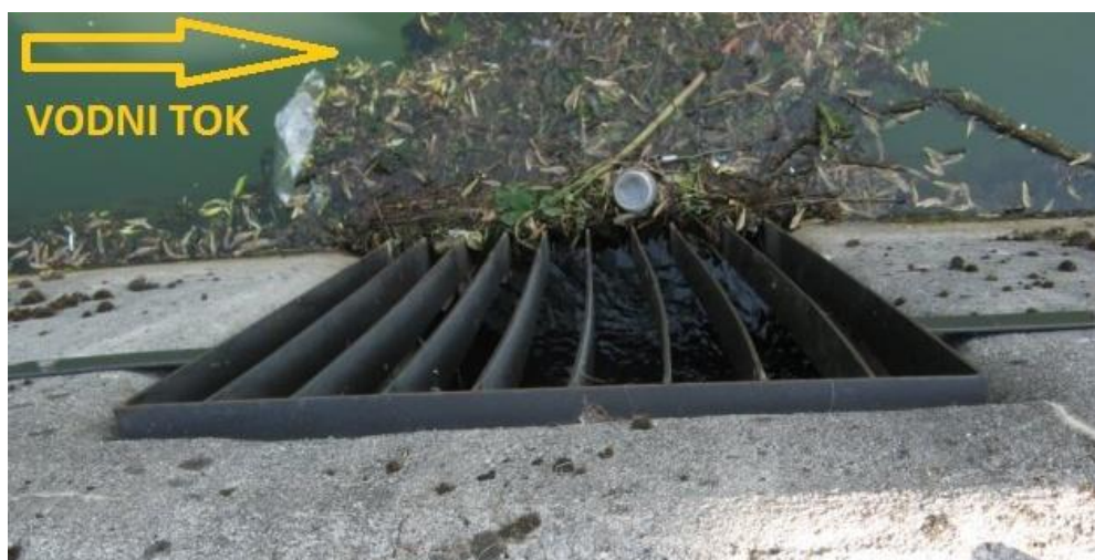
Slika 13: Zastajanje plavja ob rešetki na vtoku v ribjo stezo
