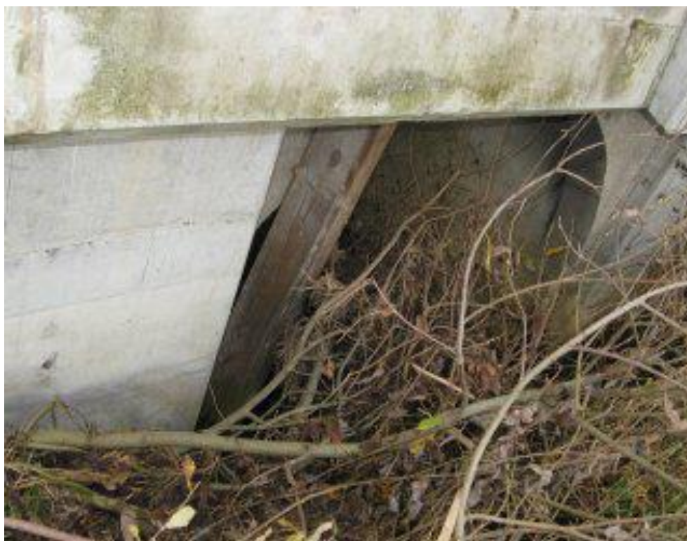
Slika 9: Premajhen in delno zamašen propust čez Volar pri križišču Ižanske in Črnovaške ceste (Globevnik, Vidmar, 2010)
