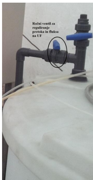
Slika 14: Vtok UF filtrata v vmesni rezervoar VG2
