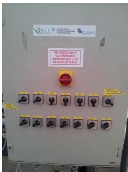
Slika 23: Krmilno napajalna električna omarica UF v fazi filtracije
