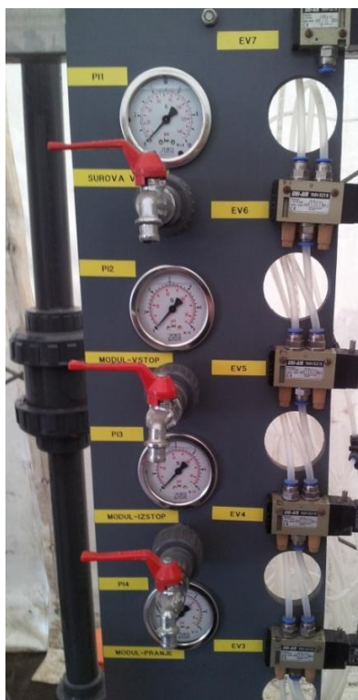
Slika 19: Manometri in pipice za odvzem vzorcev na UF procesnem sklopu
