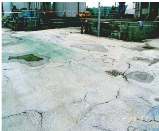
Slika 15: Razpoke v asfaltu zaradi nabrekanja žlindre v nasipnih plasteh pod asfaltom (Vir: [39])
