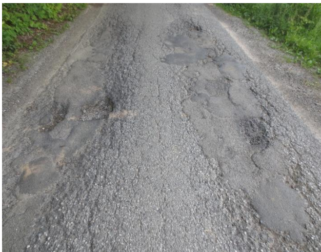
Slika 30: Površinske poškodbe in izmet na JC (vir: lastni, 2013).
