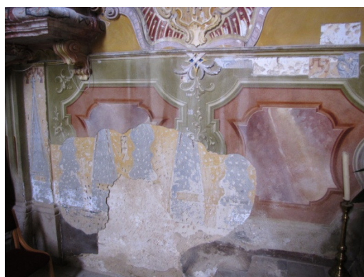
č) Predenca - Cerkev sv. Roka. Poškodbe zaradi kapilarne vlage na notranjih zidovih (Bosiljkov, Gostič, 2009).
