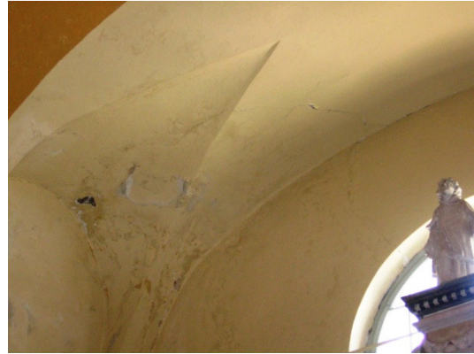
b) Kobarid - Cerkev sv. Antona Padovanskega. Poškodbe na oboku zaradi zamakanja (foto: Popović, M., 2007).
