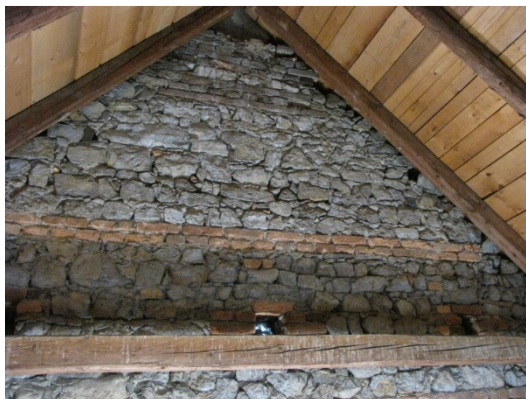
b) Kočevje - Cerkev sv. Jerneja. Struktura zatrepnega zidu na podstrešju (Bosiljkov, Gostič, 2009).
