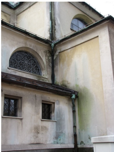
c) Ljubljana - Cerkev sv. Petra. Močne poškodbe fasade v območju žlebov in odtočnih cevi (Bosiljkov, Gostič, 2009).
