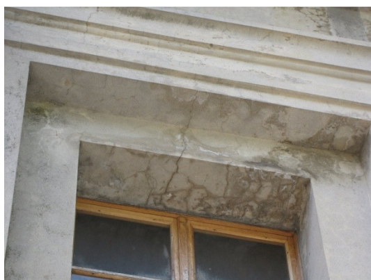
d) Log pri Vipavi - Cerkev Matere božje Tolažnice žalostnih. Poškodbe zaradi zatekanje vode v območju okenske preklade (Bosiljkov, Gostič, 2009).
