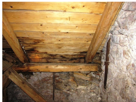
č) Nova Štifta - Cerkev Marijinega vnebovzetja. Sledovi zamakanja na opažu in strešni legi (Bosiljkov, Gostič, 2009).
