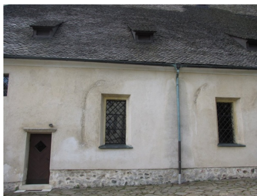
č) Slovenske Konjice - Cerkev sv. Jurija. Struktura zidov na neometanem delu fasade ob tlaku (Bosiljkov, Gostič, 2009).
