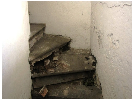
b) Ljubljana - Cerkev sv. Florijana. Poškodovano stopnišče (Bosiljkov, Gostič, 2009).
