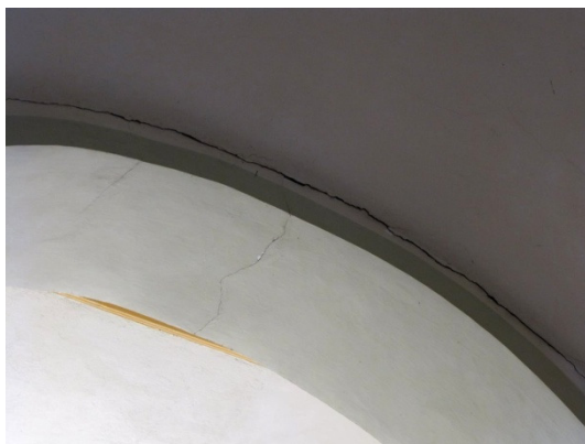
c) Log pri Vipavi - Cerkev Matere božje Tolažnice žalostnih. Razpoka na stiku loka in oboka (Bosiljkov, Gostič, 2009).
