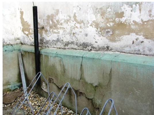
e) Turnišče - Cerkev Marijinega vnebovzetja. Poškodbe na podzidku v območju odtočne cevi (Bosiljkov, Gostič, 2009).
