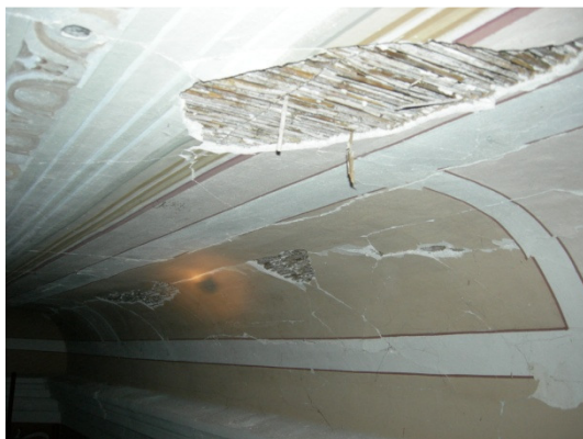
a) Bovec - Cerkev sv. Urha. Odpadanje ometa s stropa (foto: Popović, M., 2006).
