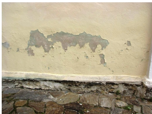
d) Slovenske Konjice - Cerkev sv. Jurija. Poškodbe zaradi kapilarne vlage na fasadi (Bosiljkov, Gostič, 2009).
