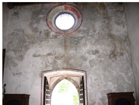
e) Tolmin - Cerkev sv. Urha. Močno poškodovan omet na steni (foto: Popović, M., 2009).
