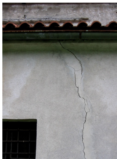
e) Tolmin - Cerkev sv. Urha. Razpoka na zidu (foto: Popović, M., 2009).
