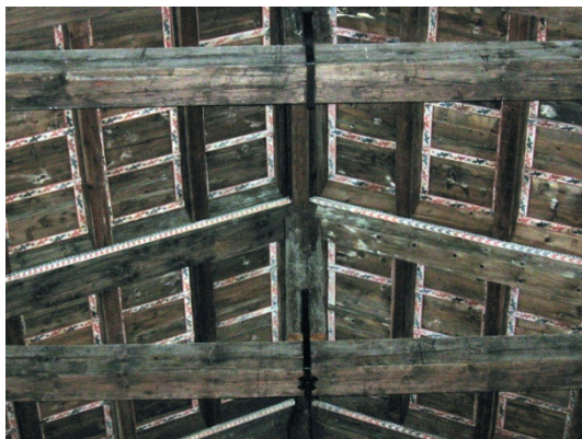
d) Tolmin - Cerkev sv. Urha. Poškodbe ostrešja zaradi zamakanja. Povešen strešni poveznik (foto: Popović, M., 2009).
