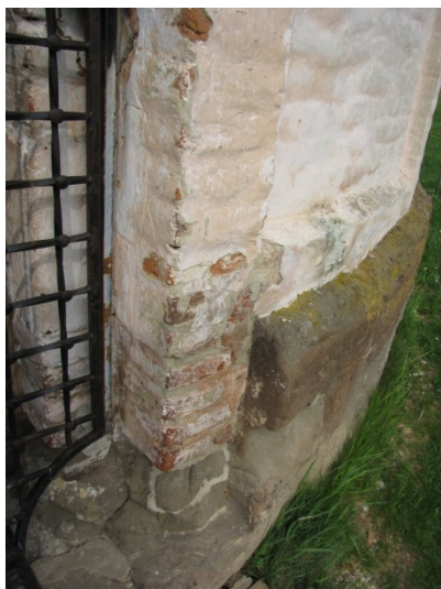
d) Selo na Goričkem - Cerkev sv. Nikolaja. Struktura zidov v območju poškodovanega ometa (Bosiljkov, Gostič, 2009).
