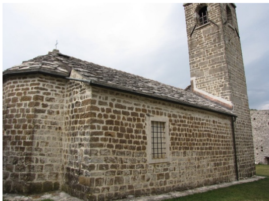
a) Hrastovlje - Cerkev sv. Trojice. Struktura zidov na neometani fasadi (Bosiljkov, Gostič, 2009).
