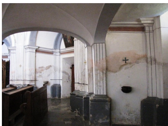
c) Nova Štifta - Cerkev Marijinega vnebovzetja. Poškodbe zaradi kapilarne vlage na notranjih zidovih (Bosiljkov, Gostič, 2009).
