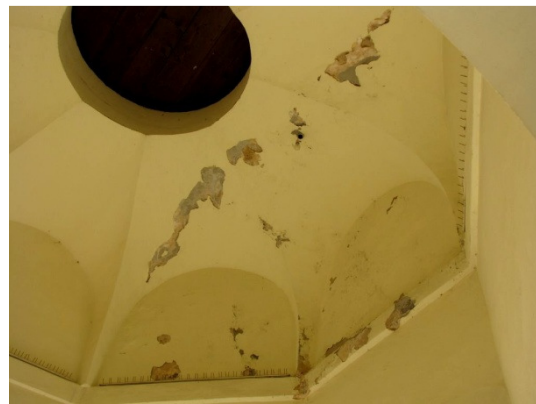
č) Log pri Vipavi - Cerkev Matere božje Tolažnice žalostnih. Odpadanje ometa na stropu zaradi zamakanja (Bosiljkov, Gostič, 2009).
