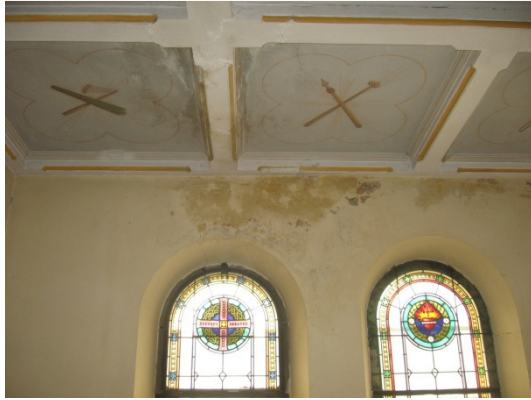
a) Drežnica - Cerkev sv. Srca Jezusovega. Sledovi zamakanja in poškodbe na stropu in zidu (foto: Štampfl, A., 2010).
