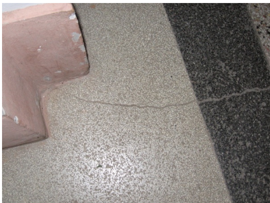
a) Bovec - Cerkev sv. Urha. Razpoka v tlaku (foto: Popović, M., 2006).
