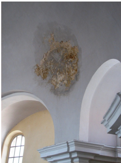
d) Maribor - Cerkev sv. Alojzija. Poškodbe zaradi zamakanja na oboku (Bosiljkov, Gostič, 2009).
