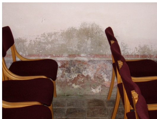
e) Tolmin - Cerkev sv. Urha. Poškodbe zaradi kapilarne vlage na notranjih zidovih (foto: Popović, M., 2009).
