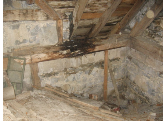
b) Drežnica - Cerkev sv. Srca Jezusovega. Poškodovana strešna lega zaradi zamakanja (foto: Štampfl, A., 2010).
