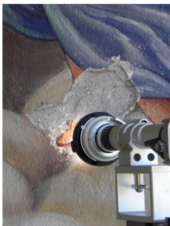
Slika 44: Fotografija tretjega merilnega mesta na kapelici na Visokem pri Kranju (delna porušitev ometa).
