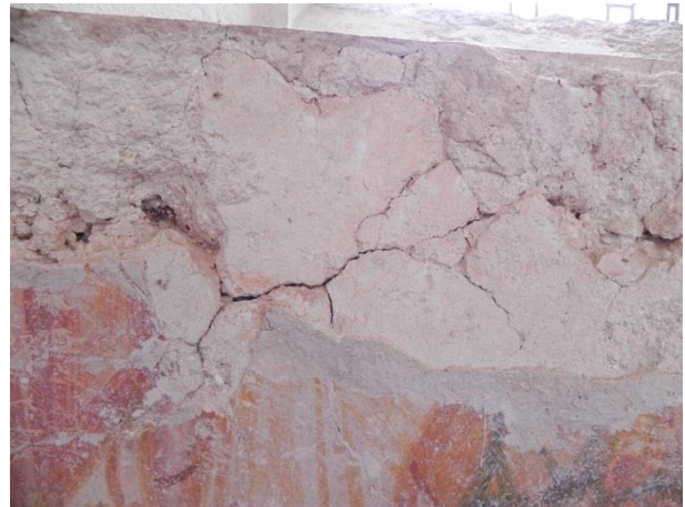
Slika 12: Razpoke pod oknom v cerkvi sv. Petra.
