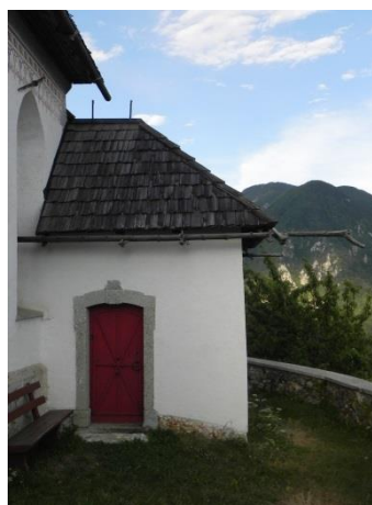
Slika 24: Primer odvodnjavanja cerkve sv. Petra – ni drenažnega sistema, leseni žlebovi, voda vseeno speljana bolj proč od zidov kot pri cerkvi sv. Radegunde.
