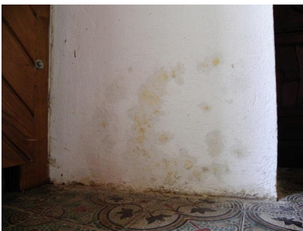
Slika 21: Vdor vlage v zidove v cerkvi sv. Radegunde.
