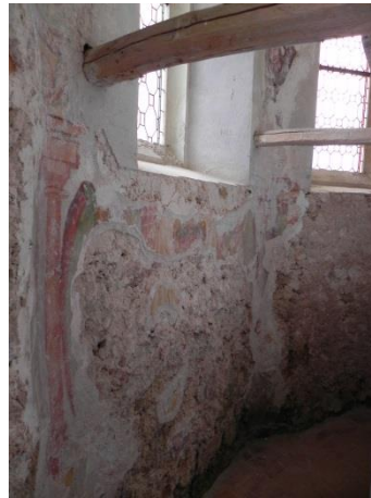
Slika 19: Razpadanje poslikav, vidna nosilna konstrukcija in deli ometov (cerkev sv. Petra).
