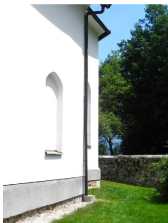
Slika 23: Neprimerno odvodnjavanje pri cerkvi sv. Radegunde – ni drenažnega sistema.
