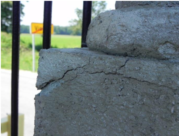
Slika 11: Razpoka na podstavku za steber pri kapelici.
