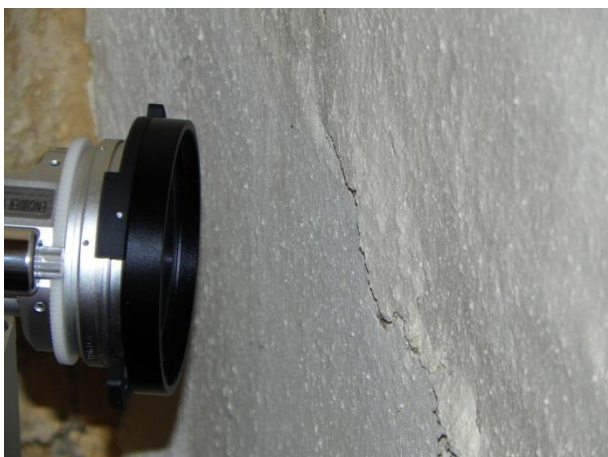
Slika 59: Fotografija osmega merilnega mesta na cerkvi sv. Radegunde (razpoka).
