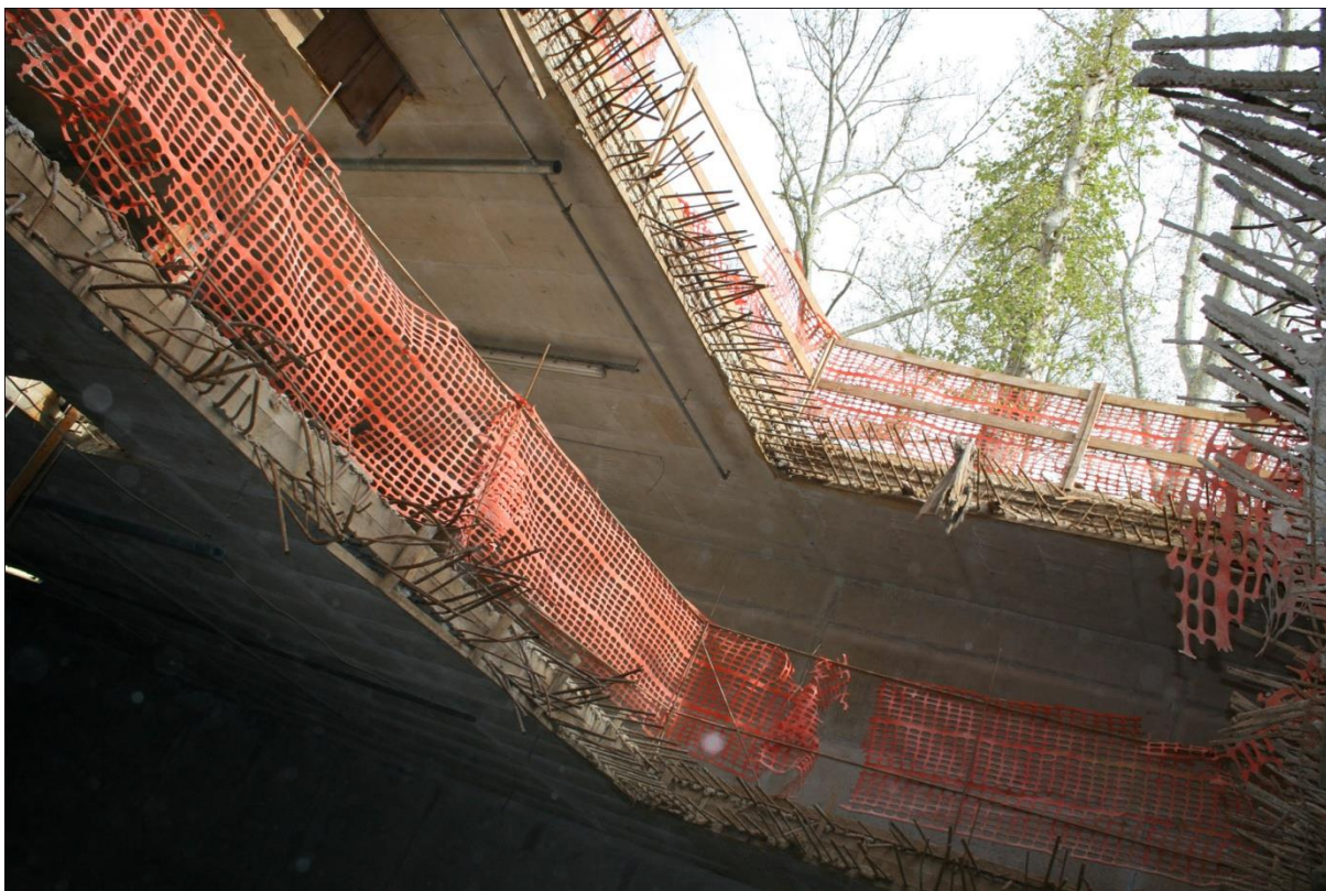
Slika 21: Odprtine za transport izkopanega materiala, Parkirana hiša Kongresni trg. (Vir: Foto Janez Mikec)
