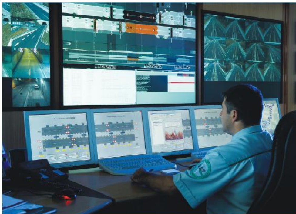
Slika 2: Nadzorni center za nadzor prometa v predorih [2]
