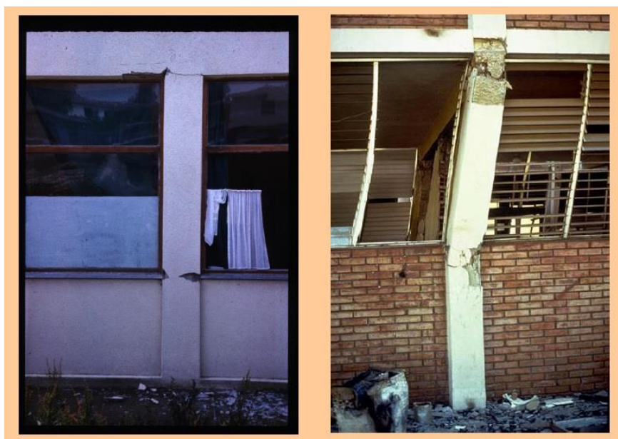
Slika 5: Primer poškodbe okvirne konstrukcije zaradi nepopolne zapolnitve prostora s polnilom (Fajfar, 2011)
