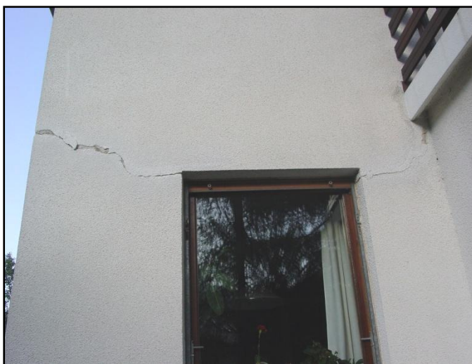
Slika 13: Diagonalni razpoki v višini robov okna (DTP, 2012a)
