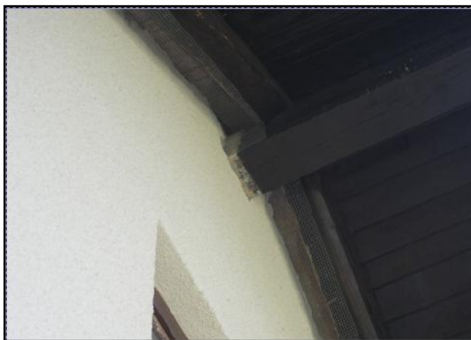
Slika 17: Primer obravnavanega opečnega objekta, kjer se zatepni zid nagne proti notranjosti za 5 cm (DTP, 2012a)
