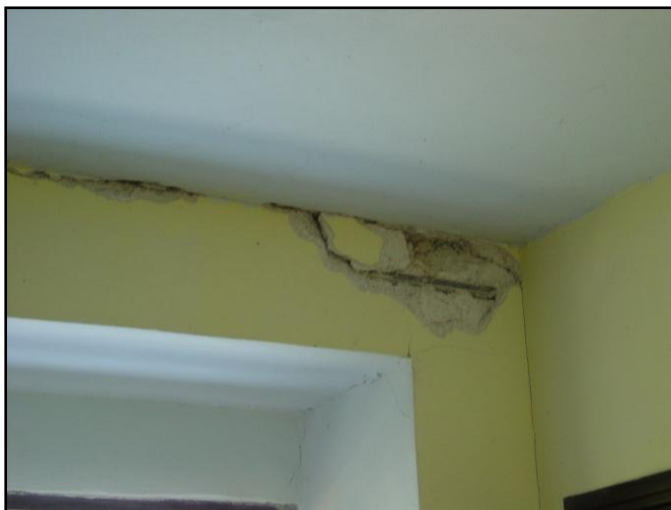
Slika 14: Horizontalna razpoka pod stropom v kamnitom zidu v območju jeklenih vezi (DTP, 2012a)
