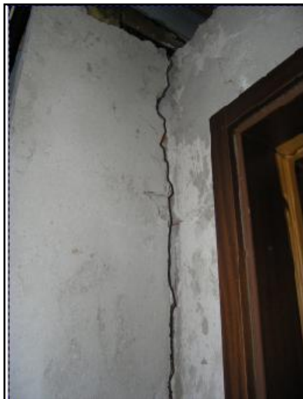
Slika 15: Vertikalna razpoka na stiku dveh kamnitih sten (DTP, 2012a)
