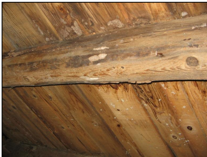
Slika 16: Pojav lesnih gob, plesni in črvičnosti lesa strešne konstrukcije (DTP, 2012a)
