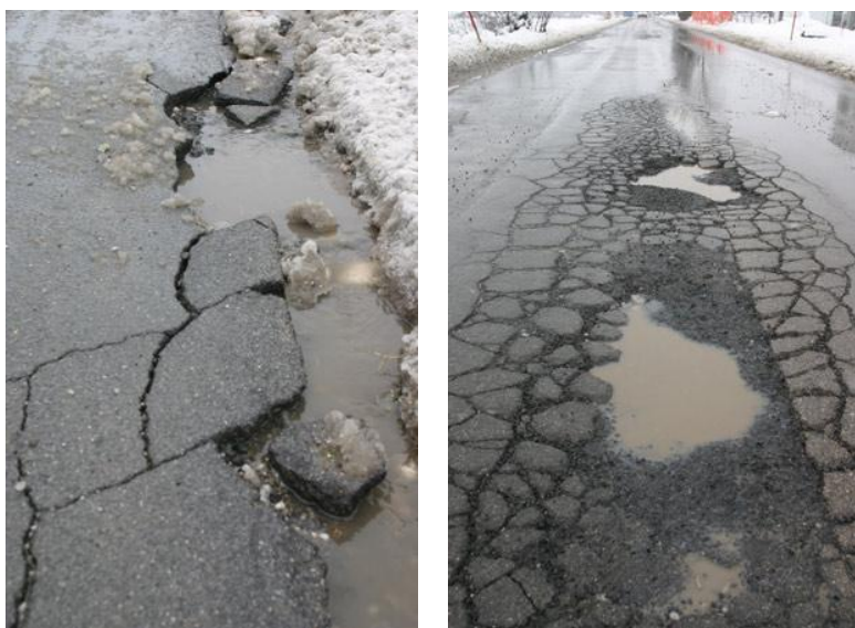
Poškodbi na vozišču zaradi vpliva zmrzovanja in tajanja (Vir: http://www.motorevija.si/ , 13.7.2010)
