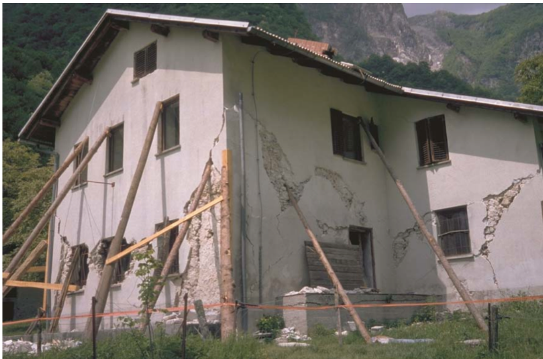
Slika 9: Tipične poškodbe na kamniti hiši (ARSO, 2012b)
