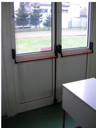
Slika 12: Požarna vrata (izhod D).
