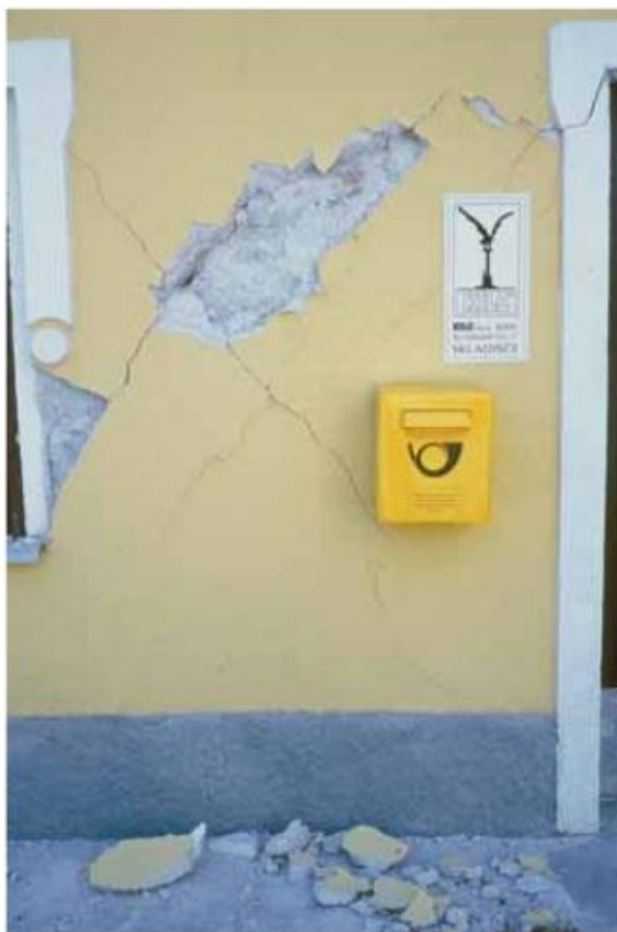
Slika 4: Diagonalne razpoke na pošti v naselju Čezsoča (ARSO III, 2006)
