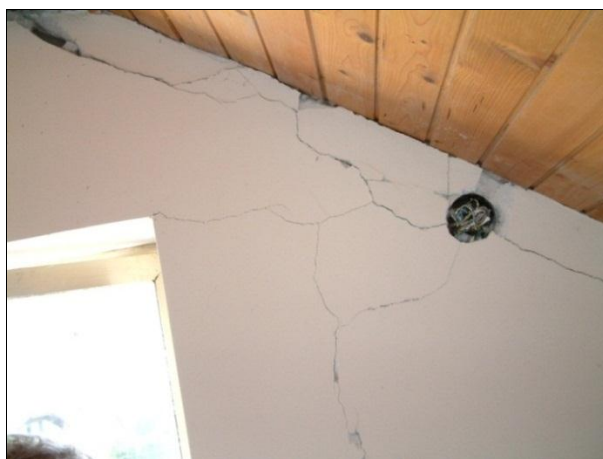
Slika 9: Diagonalne razpoke v zatrejni steni objekta Mala vas (Državna tehnična pisarna, 2013)
