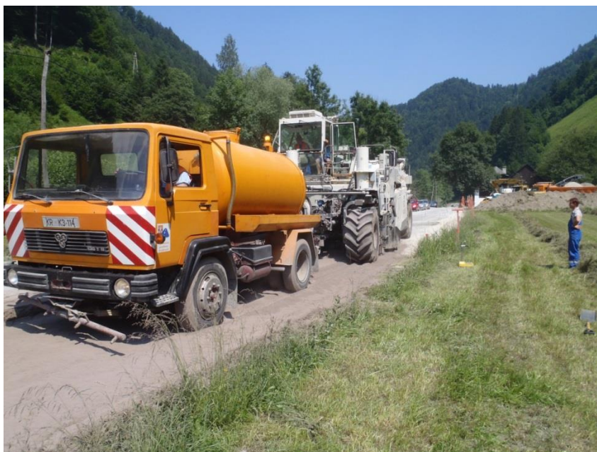
Slika 32: Cisterna z vodo (Bebar, 2013)
