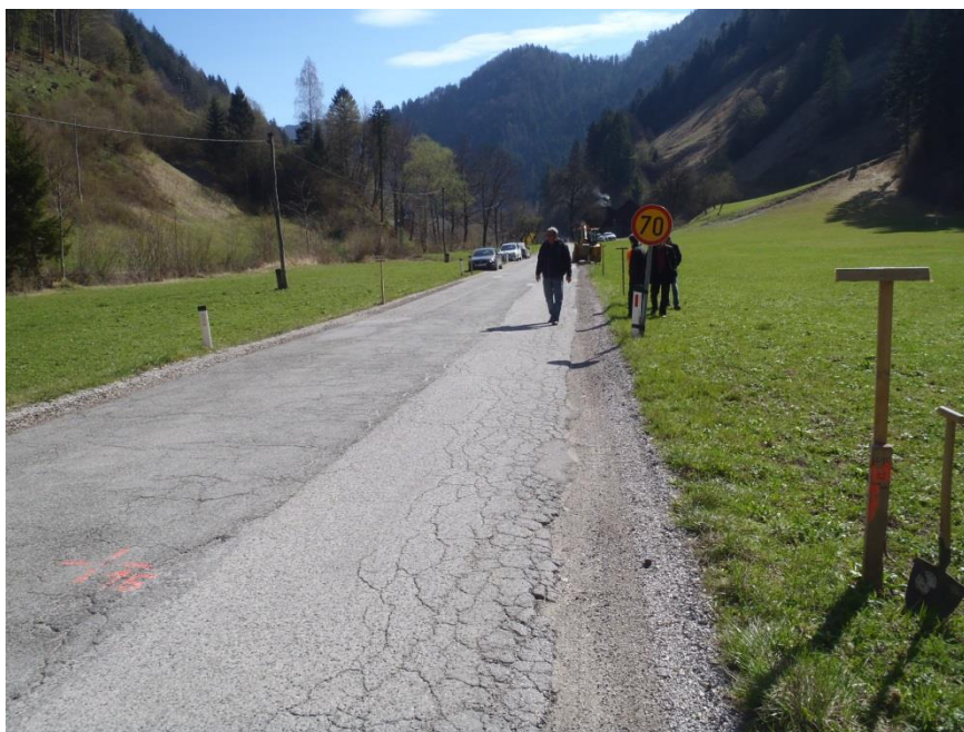
Slika 27: Prikaz slabega stanja ceste (Bebar, 2012a, str. 2)
