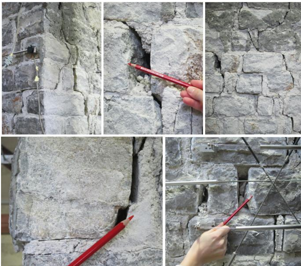
Slika 111: Izpraznjene spojnice injektiranega zidu
