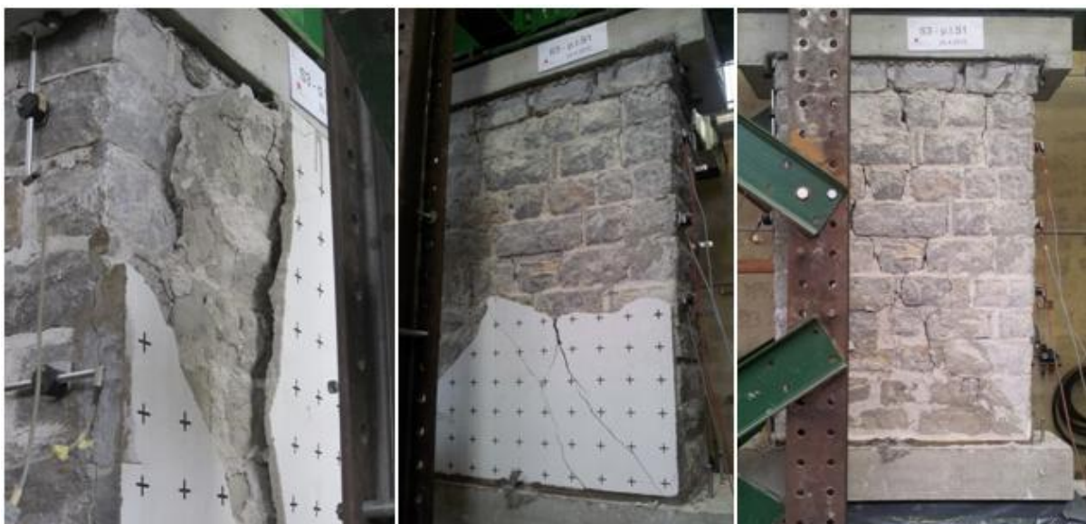
Slika 85: Delna in dokončna porušitev ometa Zidu 2
