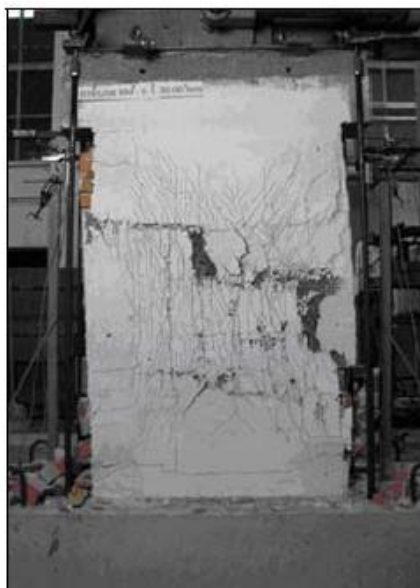
Slika 68: Porušitev zidu s tankim slojem ometa [50]
