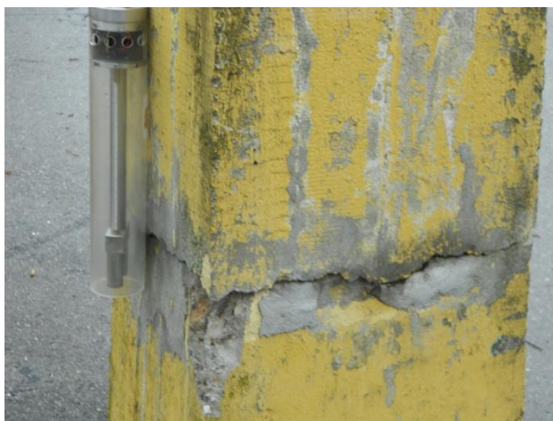
Slika 4: Razpoka na stebru O7N
