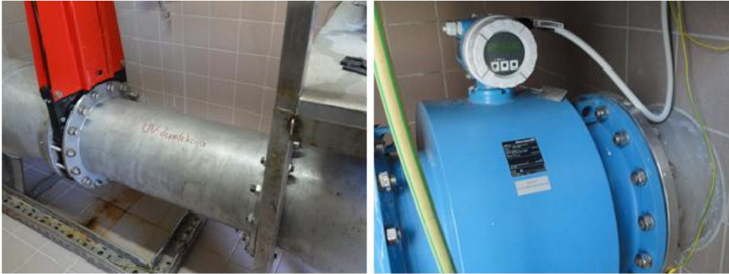
Slika 23: Mesto vgraditve cevne UV naprave za dezinfekcijo vode (levo) in cevni induktivni merilnik pretoka (desno)
