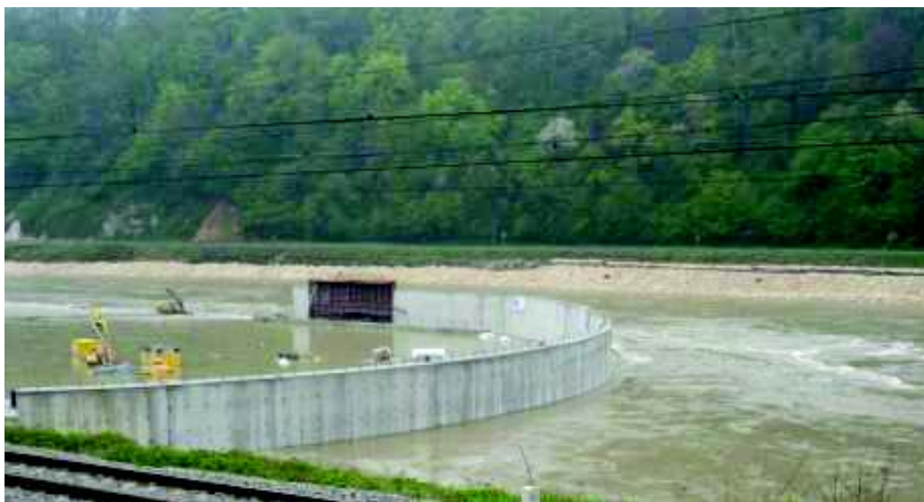
Slika 25: Poplavitve prve gradbene jame, na levem bregu (gorvodno)
