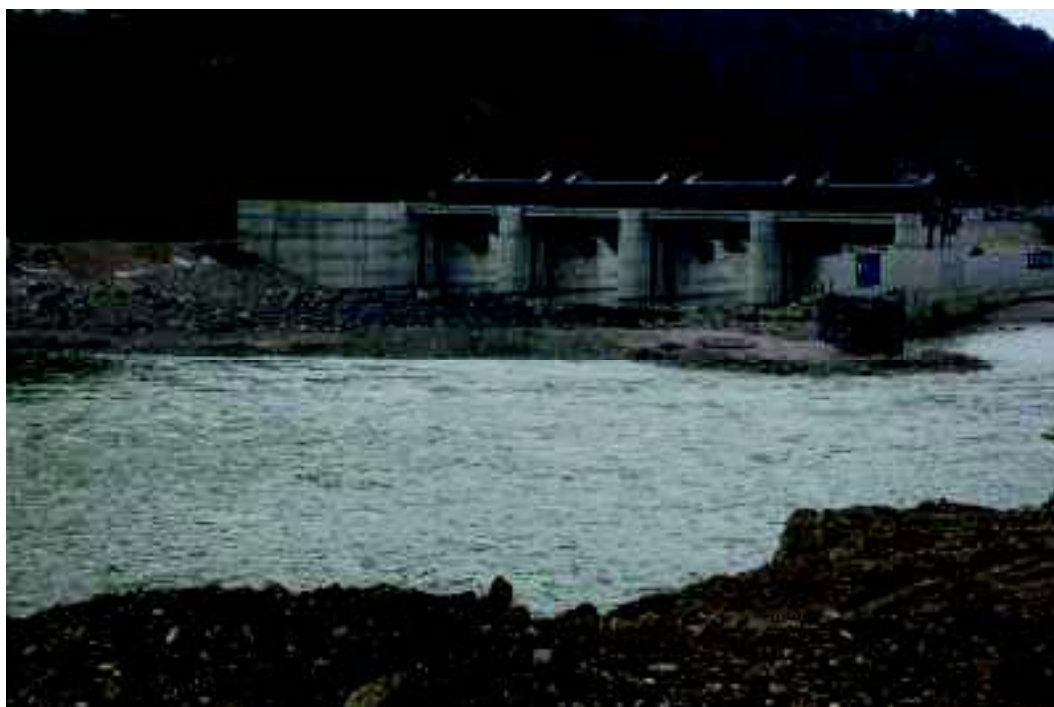
Slika 12: Rušitev gorvodne ločne pregrade leve gradbene jame in preusmeritev reke Save na prelivna polja
