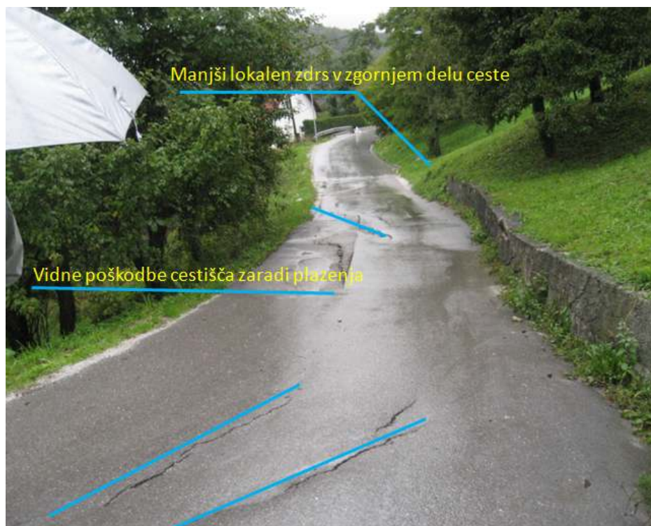
Slika 24: Poškodovana cesta pred sanacijo (Marodi, 2011, str. 3)
