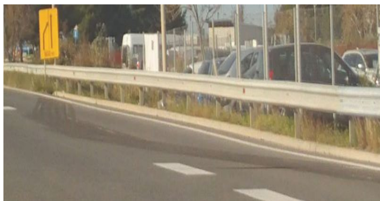
Slika 52: Odstranjena zaporna ploskev med priključkom Koper - center in izvozom za bencinsko črpalko v smeri proti Izoli.
