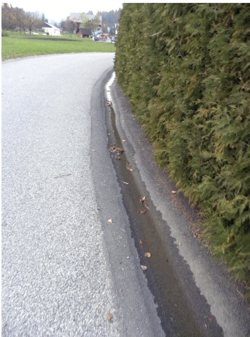
Slika 26: Obstoječi odprti meteorni kanal v naselju Žlebič
