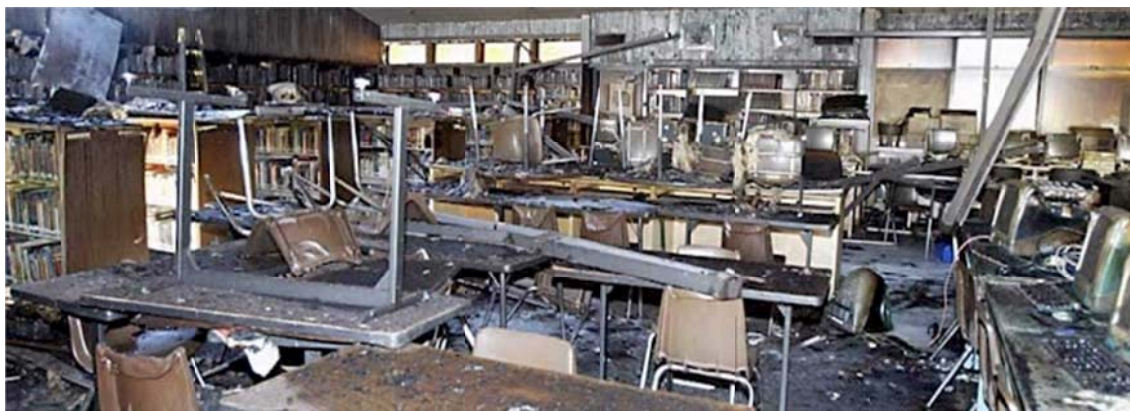
Slika 7-1: Primer porušitve jeklenih elementov v knjižnici (vir:chicora.org/fire.html)
