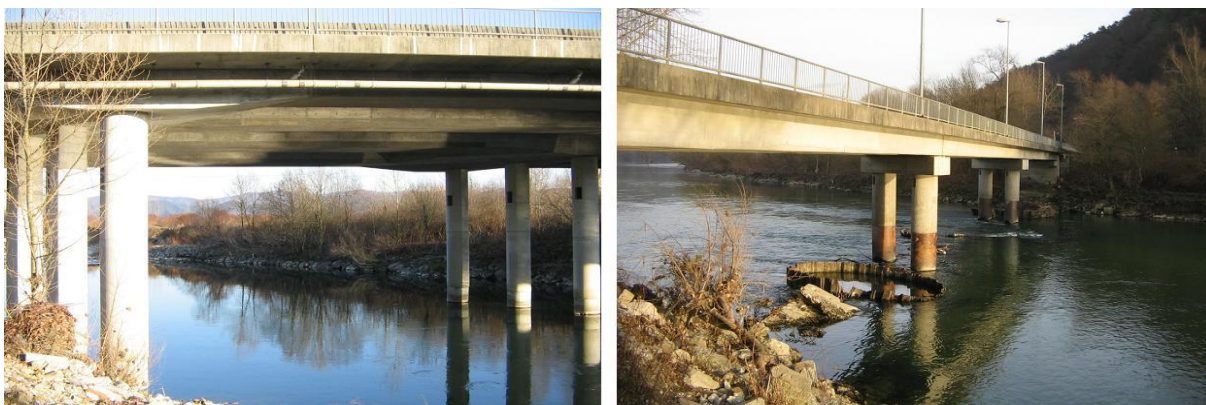
Slika 13: Avtocestni most pri Šentjakobu z dovolj višinske rezerve (levo) ter most v bližini naselja Laze pri Dolskem katerega bo potrebno porušiti ter nadomestiti z novim (desno).
