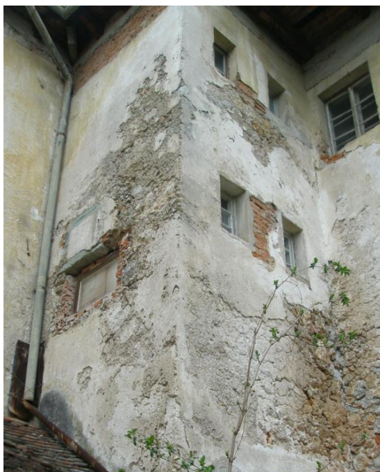
Slika 11: Izpran in poškodovan omet
