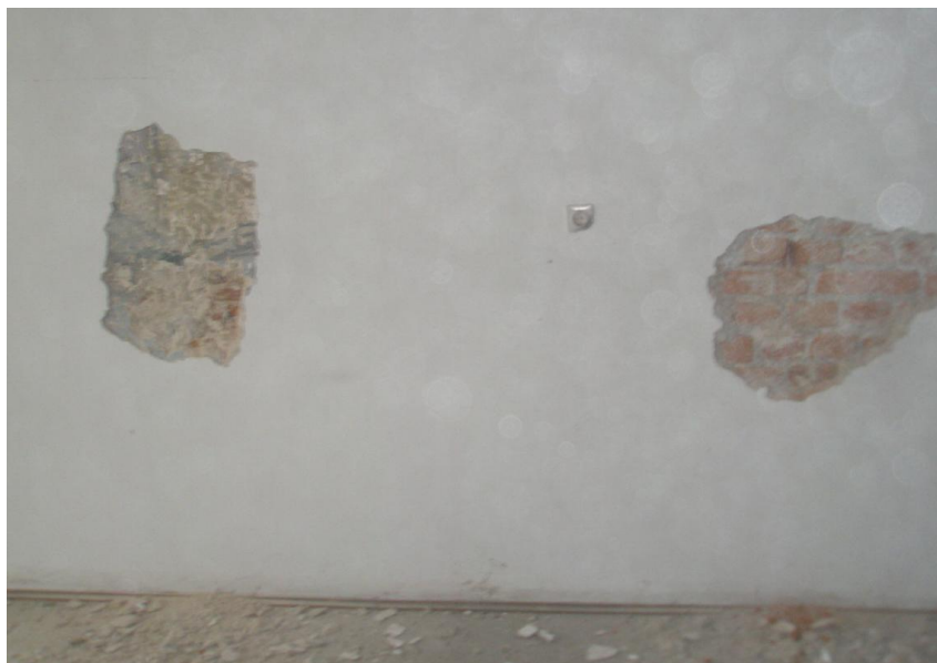
Slika 8: Nekonsistentnost uporabljenega gradbenega materiala na enem zidu
