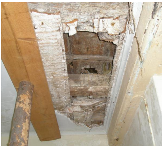
Slika 13: Porušen lesen strop
