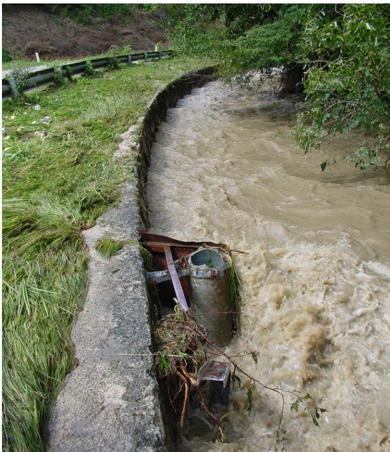
Slika 15: Odlomljena vodna postaja v kraju Orešje na Sevnični 22.8.2005.
