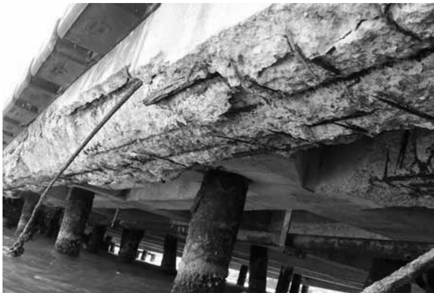
Slika 1: Porušena struktura betona kot posledica agresivnega okolja (Carrasquillo Associate, LTD. 2010)
