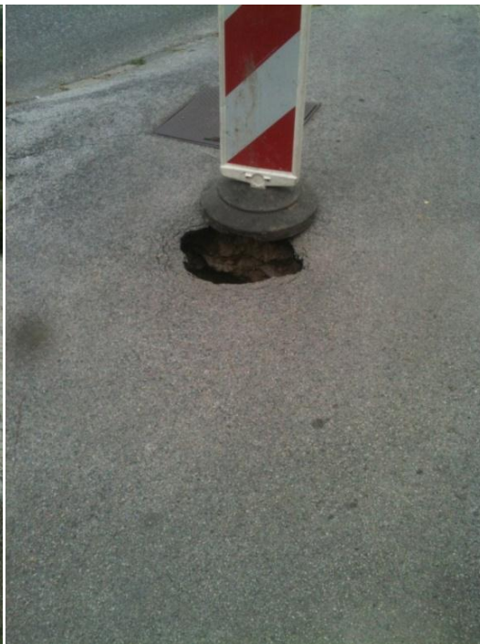
Slika 7: Poškodbe na vozišču
