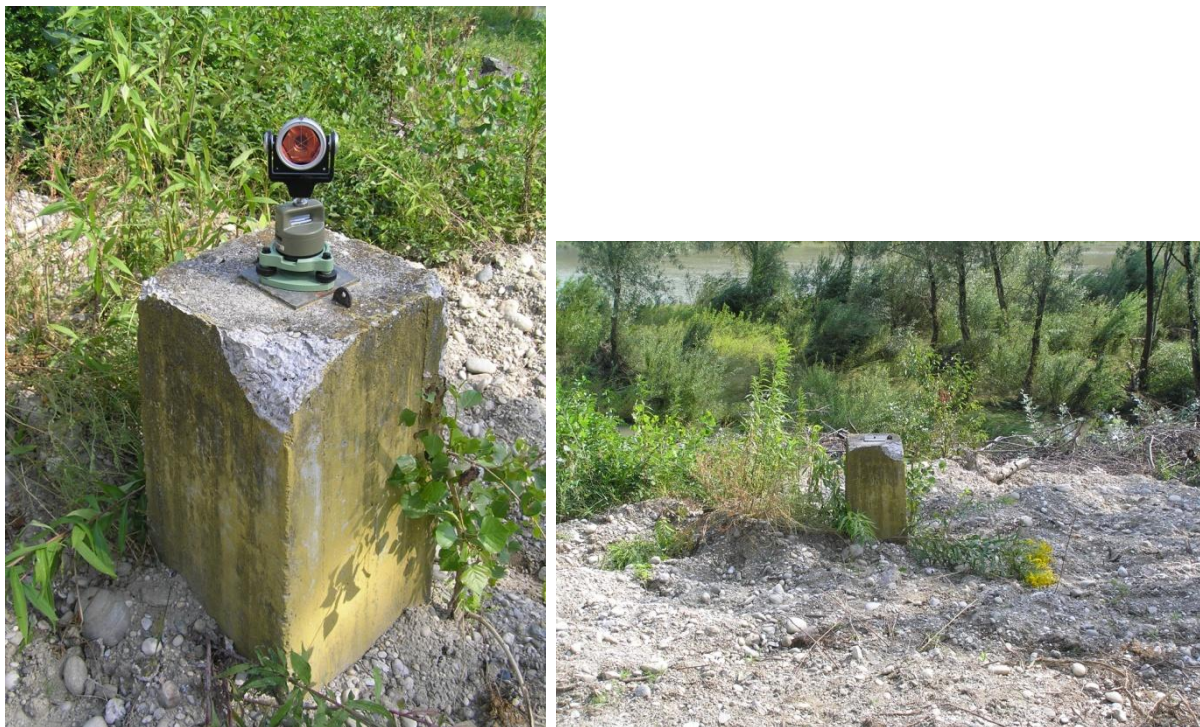
Slika 16: Poškodovan opazovalni steber O5
