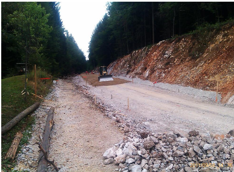
Slika 13: Nasutje tampona železniške proge (foto: Žnidaršič)
