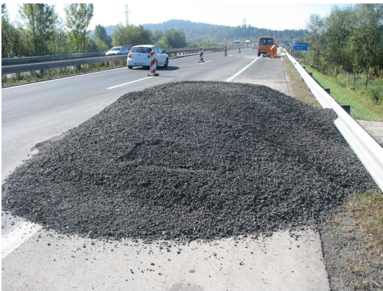
Slika 47: Dotrajano plast drenažnega asfalta je bilo potrebno strojno odstraniti - porezkati (lasten vir)
