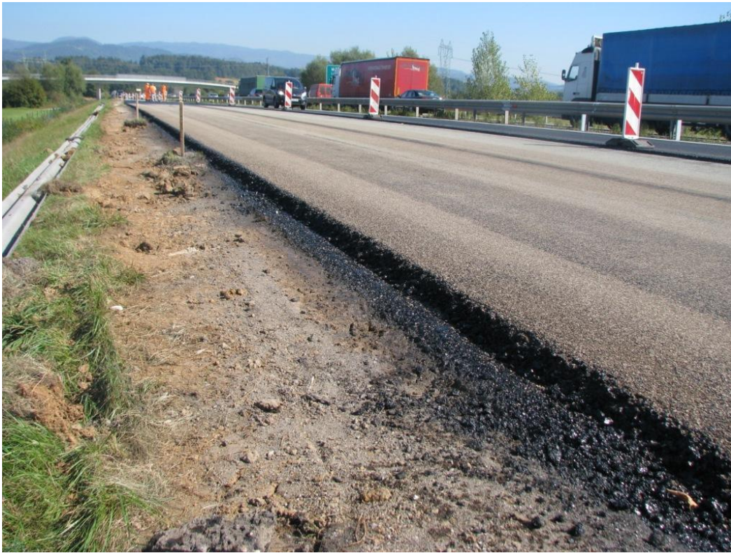
Slika 49: Na pobrizg bitumenske emulzije se je nato izvedel posip zrn drobirja (lasten vir)
