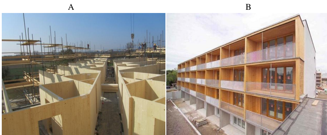
Slika 26: A-Nadgradnja hotela Terme v Termah Čatež z dvema etažama iz križno lepljenih plošč; B-Večnadstropni stanovanjski objekt na Dunaju (CBD).
