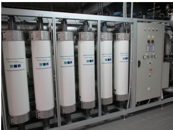
Slika 10: Moduli ultrafiltracije v vodarni Cepki
