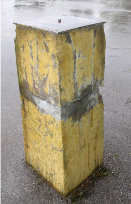
Slika 12: Saniran steber O7N
