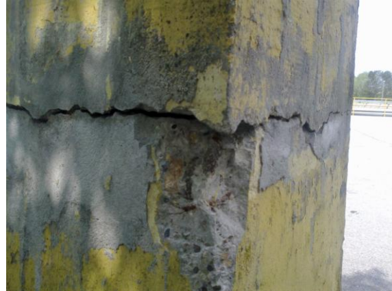
Slika 11: Pojav razpoke na stebru O7N
