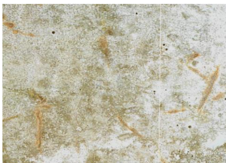
Slika 41: Korozija jeklenih vlaken, ki so do 5 mm pod površino, po 12 letih izpostavljenosti zunanjim vplivom v industrijskem okolju
