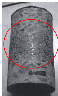
Slika 33: V iz industrijskega tlaka izrezanem valju se opazi kepa (gruda) jeklenih vlaken, kar predstavlja nehomogenost porazdelitve jeklenih vlaken v strjenem betonu
