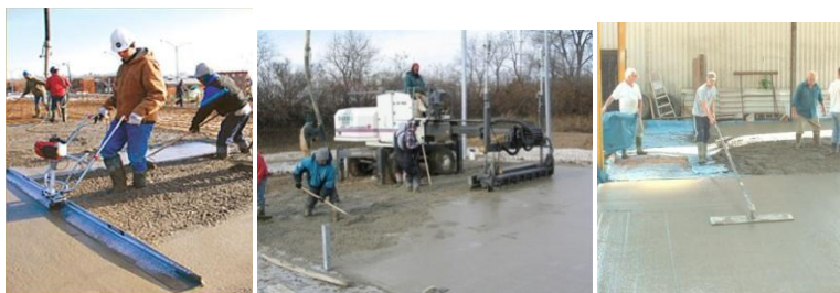
Slika 36: Obdelava površine z vibracijskimi ravnalkami (levo), laserskimi gladili (v sredini) in kovinskimi gladilkami (desno)
