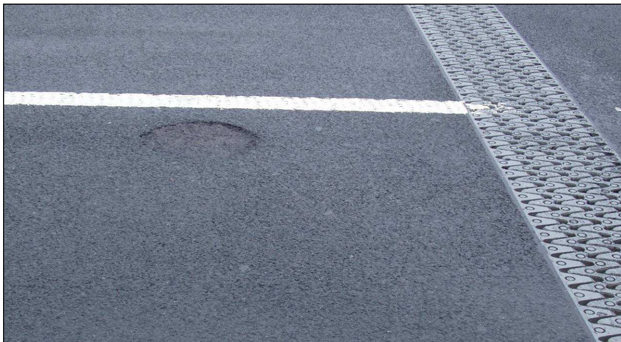
Slika 30: Poškodba asfalta na voznem pasu
