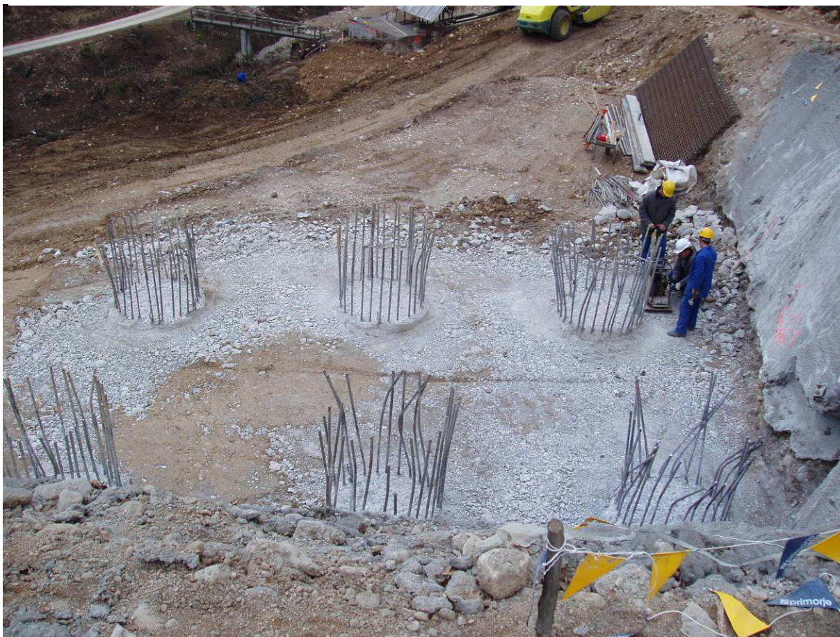
Slika 22: Piloti na podpori 5D po odbitju nekvalitetnega betona – glave pilota
