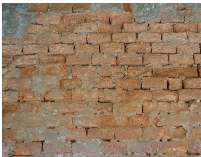
Slika 11: Erozija zaključnih fug spojnic na fasadnem zidu
