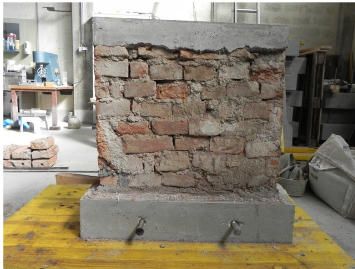
Slika 50: Prikaz razpokanosti na ZID-u 2 pred obremenitvijo
