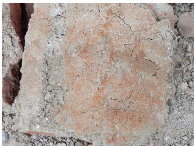
Slika 12: Razpokanost maltne spojnice, izguba adhezije
