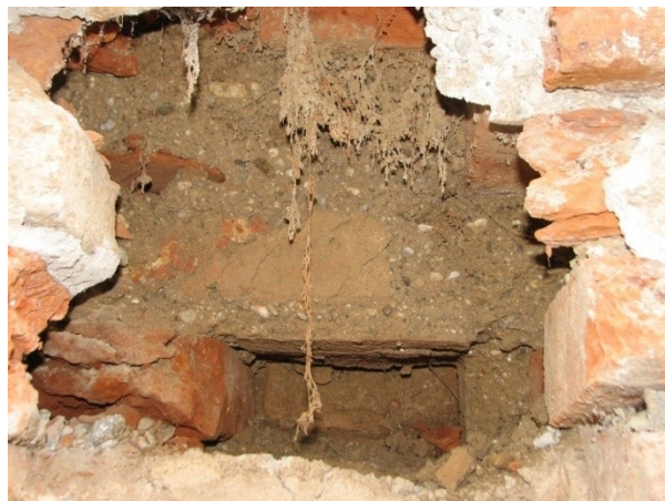
Slika 9: Notranjost zidu je povsem navlažena, na zunanji strani je zid suh
