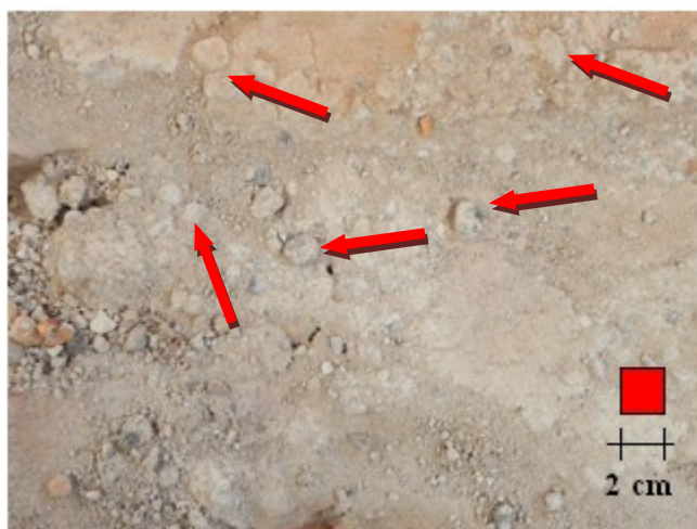
Slika 10: Nadmerna zrna v horizontalni spojnici parapetnega zidu
