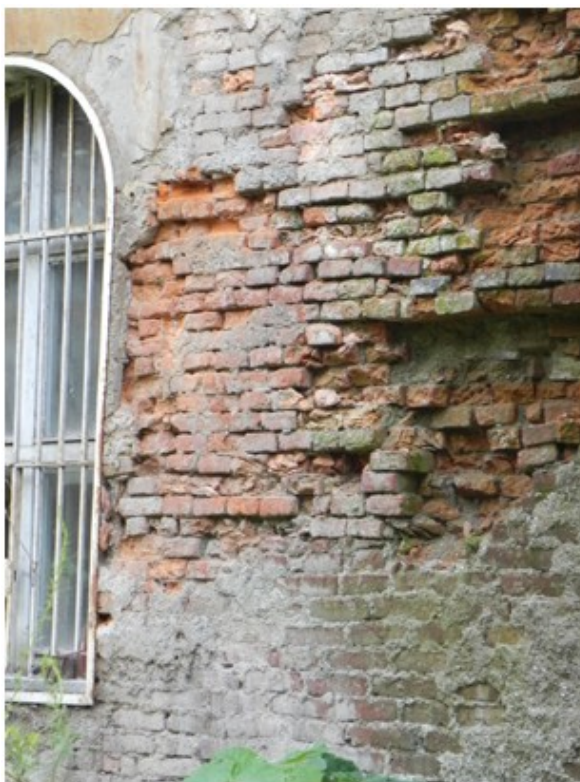
Slika 3: Posledice večletnega navlaževanja zidu
