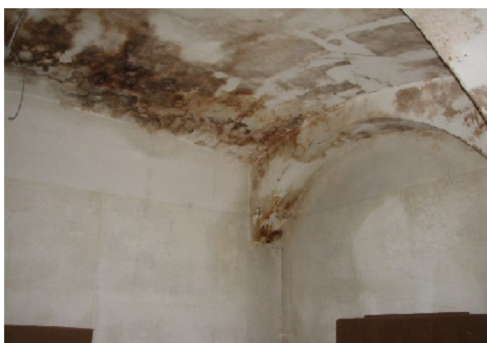
Slika 4: Posledica kapilarnega dviga vode (Bosiljkov in sod., 2008)
