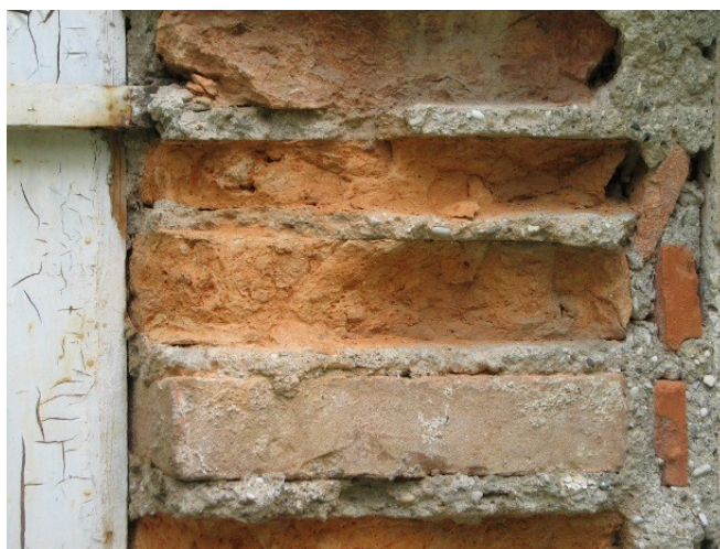
Slika 7: Izgled in primerjava propadanja med svetlo in temno opeko na fasadnem zidu
