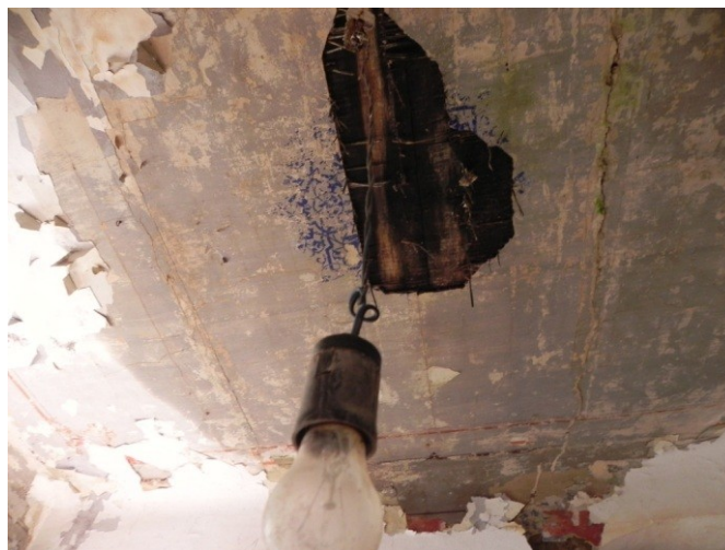
Slika 6: Stanje lesenega stropa v 1. nadstropju
