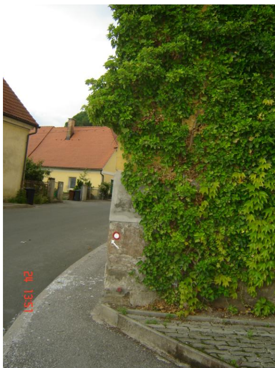
Slika 5.9: Problem postavitve late na reper R4 zaradi rastja na objektu
