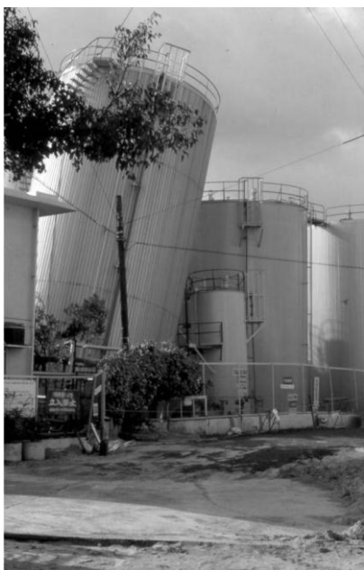
Slika 4: Porušitev rezervoarja zaradi vertikalnih pomikov
