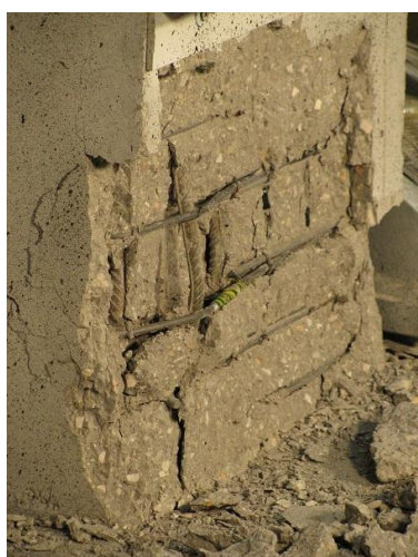
Slika C.11: Porušitev krovnega sloja betona
