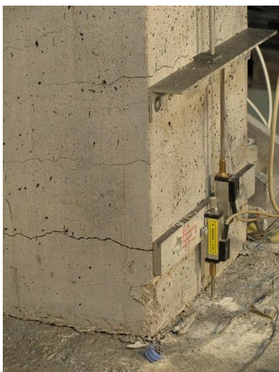
Slika C.8: Razpokanost betona v nateznem delu prereza (v pasnici)
