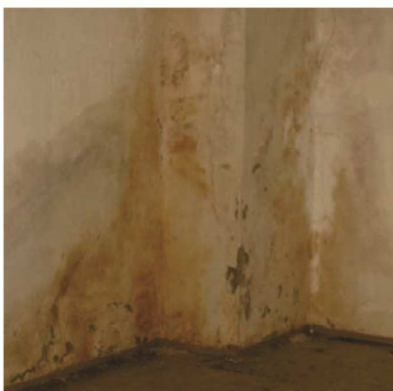
c) Poškodbe ometa zaradi kapilarnega dviga
