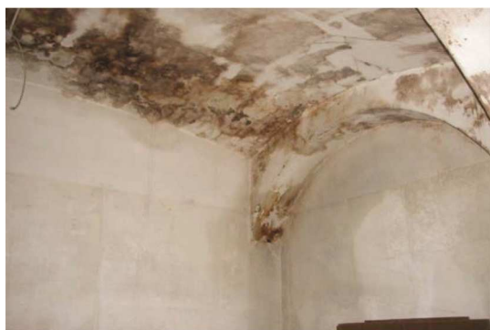
a) Poškodbe ometa na oboku (plesen)
